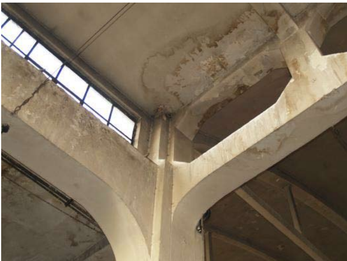
Foto 48. Charakterystyczne połączenie elementów konstrukcyjnych części „wysokiej” i „niskiej” hali – zawilgocenie stropu.
