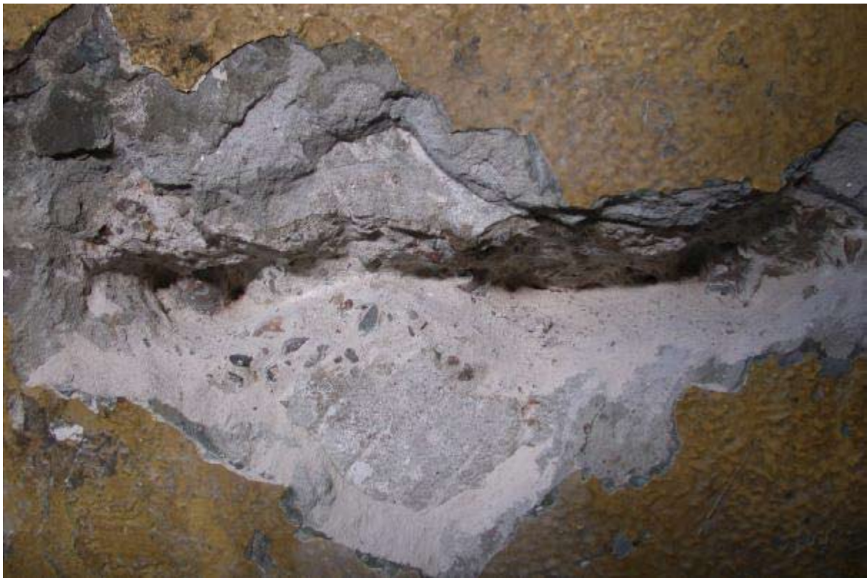
Foto 58. Odkrywki zbrojenia słupa w osiach C/4.
