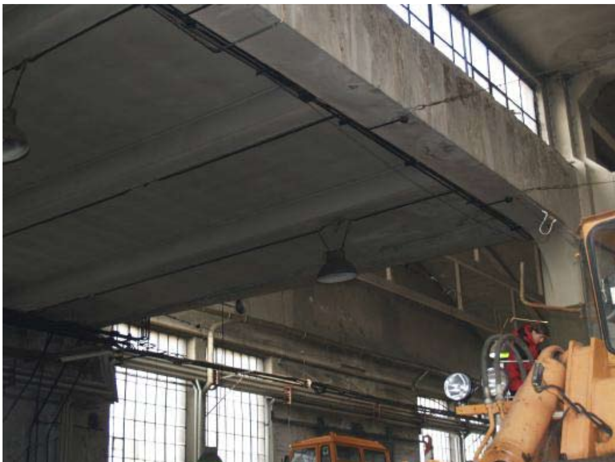
Foto 49. Belki części niskiej i zawilgocenie przy paśmie okien.
