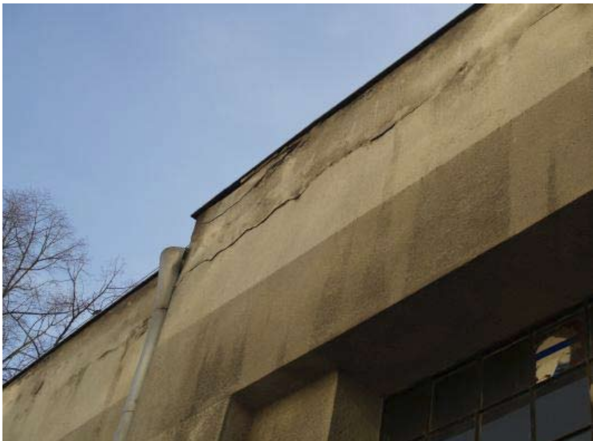
Foto 26. Spękania poziome między konstrukcją stropu i ścianą kolankowej.
