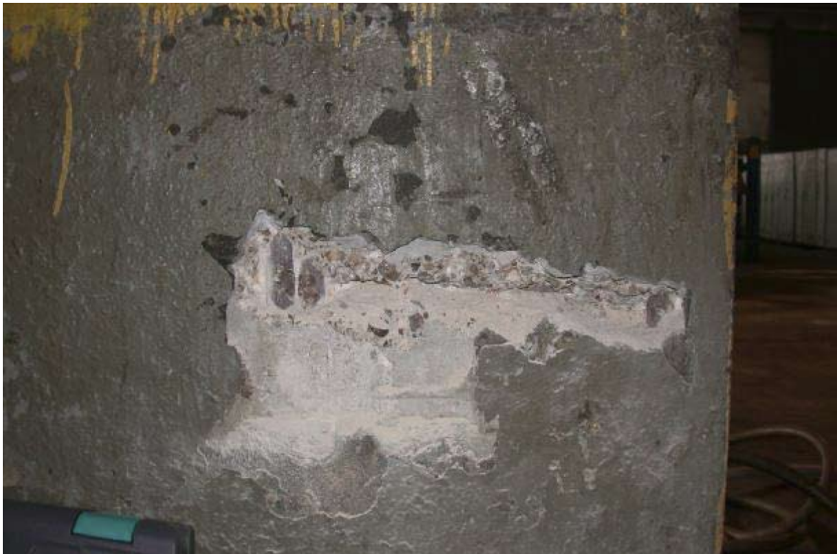
Foto 59. Odkrywki zbrojenia słupa w osiach C/4.
