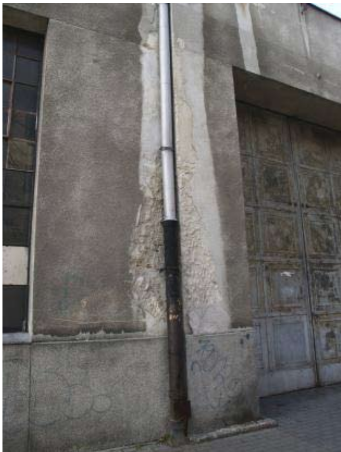
Foto 17. Widok na zawilgoconą część ściany.
