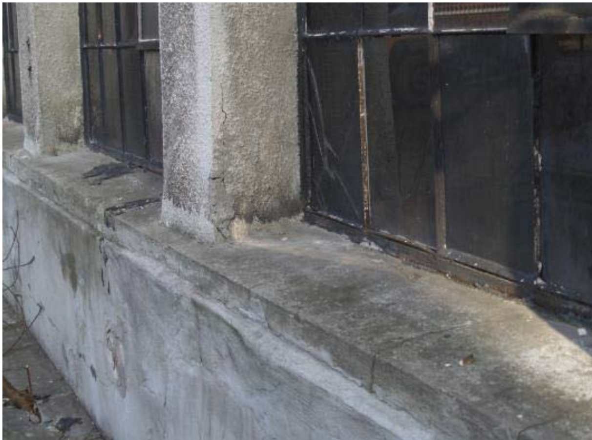
Foto 6. Liczne spękania tynków przy oknach i brak parapetów.
