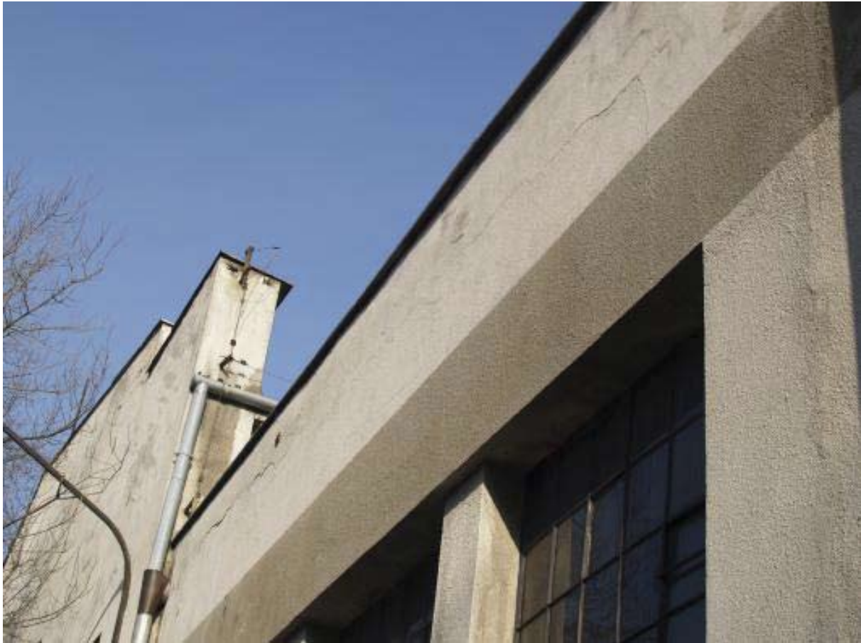
Foto 5. Widok ścianki kolankowej z widocznymi rysami oddzielającymi się od konstrukcji (rysy poziome).
