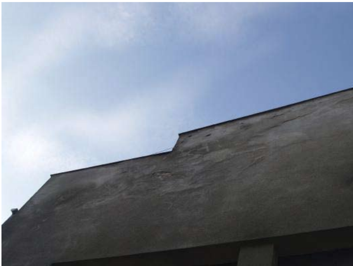
Foto 19. Zawilgocenie i spękania w centralnej części elewacji od ulicy Sandomierskiej.
