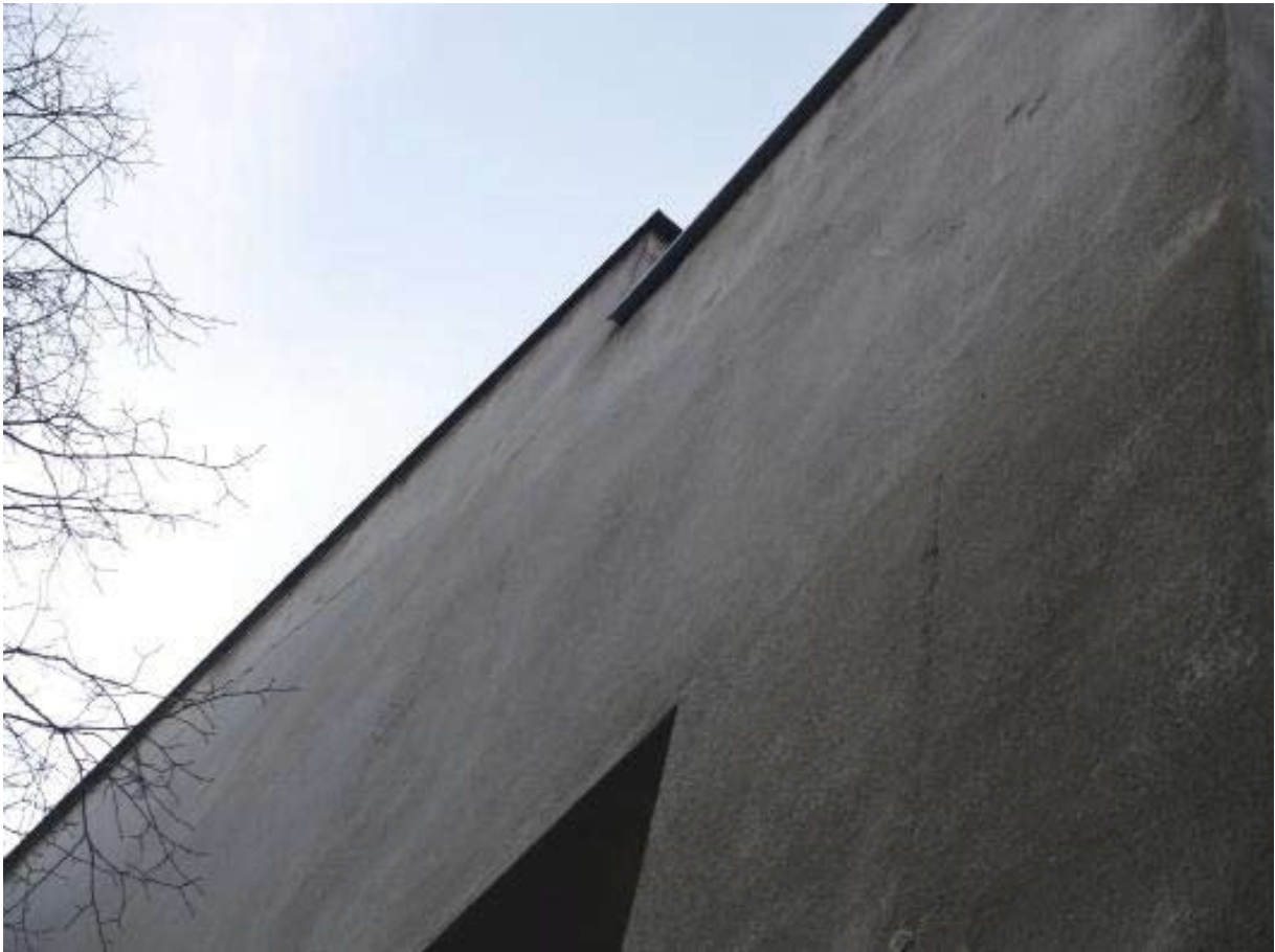
Foto 21. Rysy poziome (oddzielenie się ścianek kolankowych) i pionowe w elewacji (oddzielenie się ścian od konstrukcji słupów).
