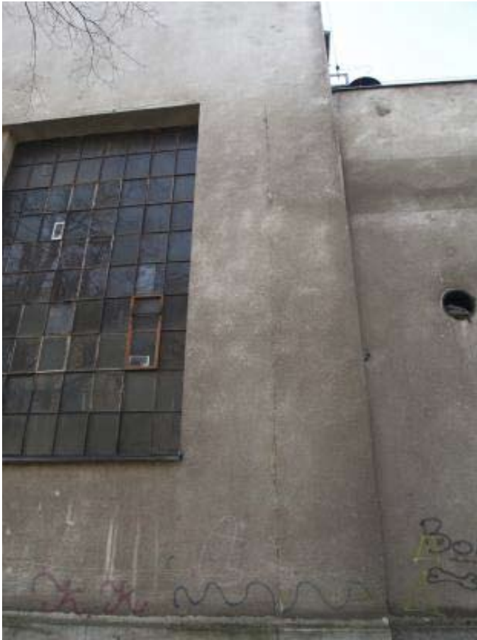
Foto 23. Widoczne oddzielenie się pionowe materiałów ściany i słupa w elewacji.
