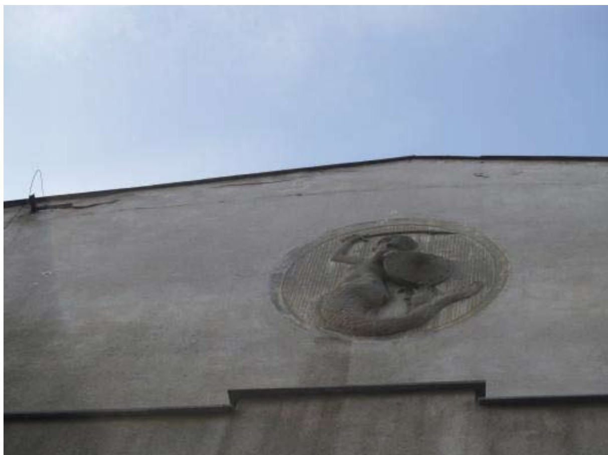
Foto 20. Rysy poziome w elewacji.
