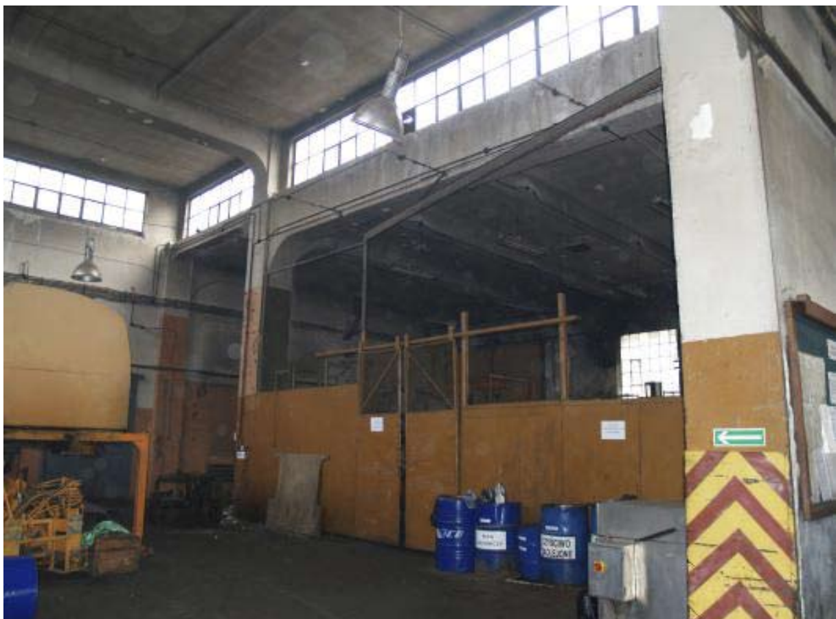
Foto 38. Skrzydło północne – magazyny – widoczne zawilgocenie podciągu żelbetowego.
