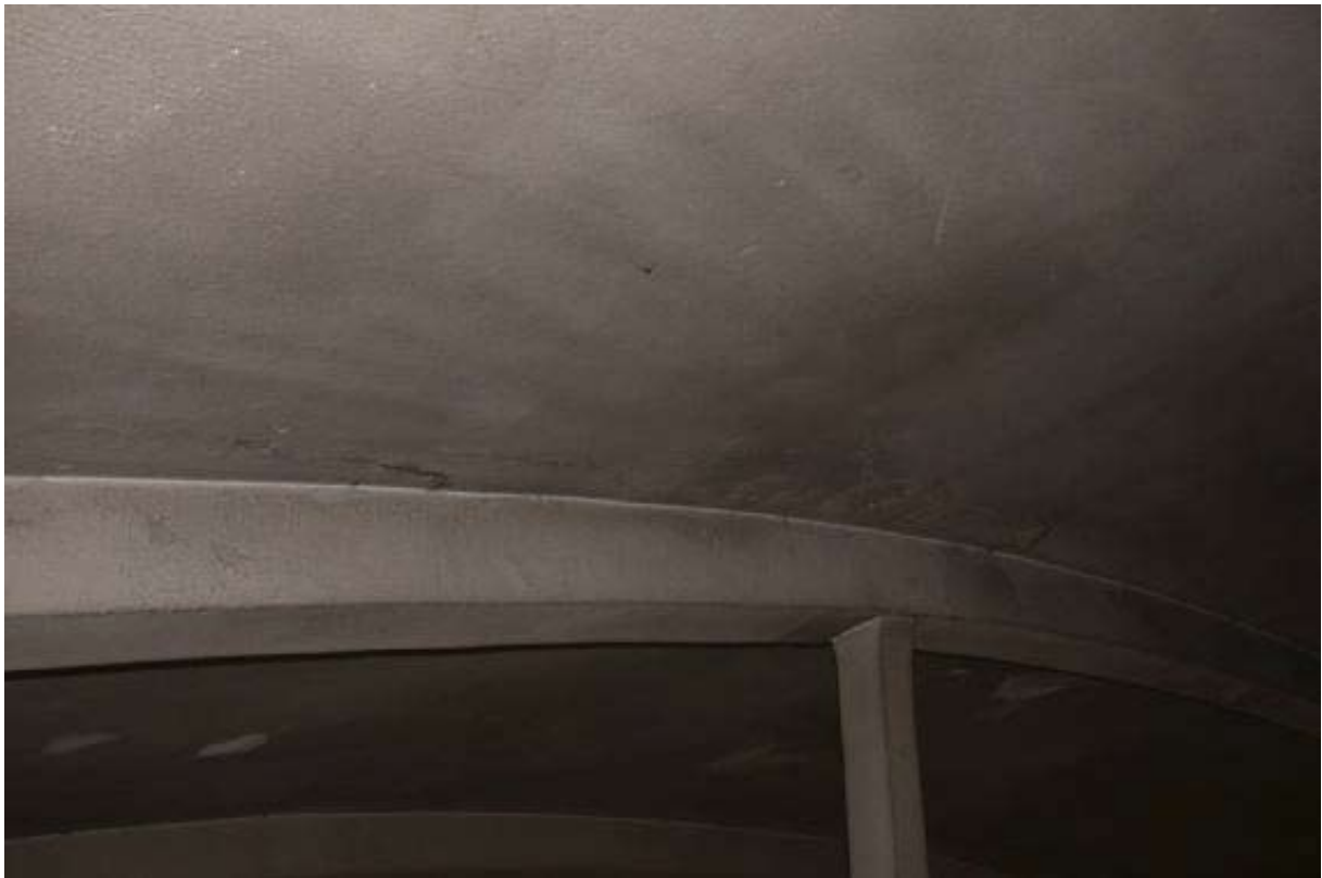
Foto 56. Zarysowanie płyty stropowej przy kratownicy łukowej w osiach 4-5.
