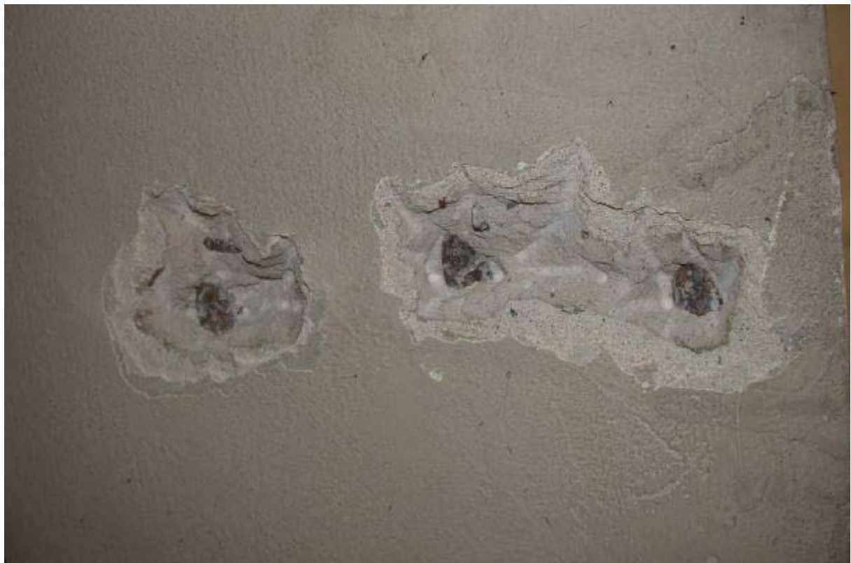
Foto 61. Odkrywka zbrojenia podciągu w osi B.
