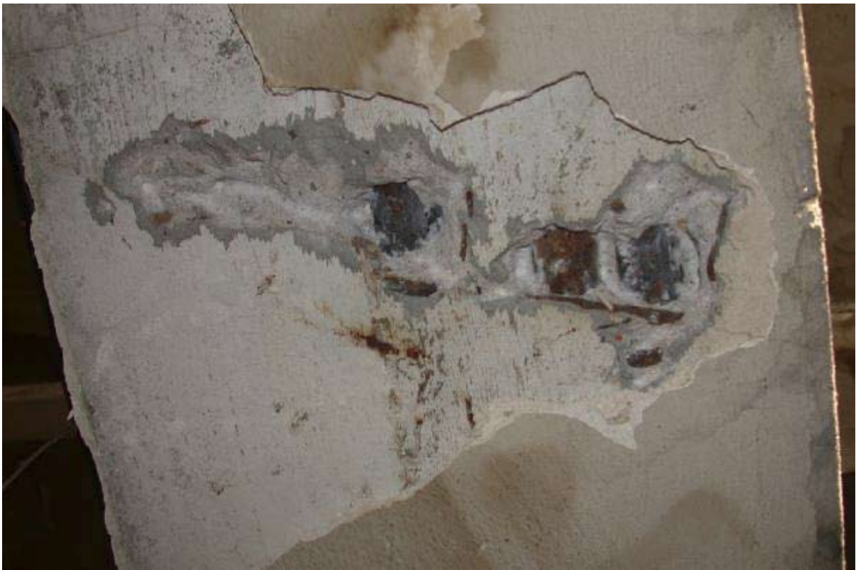
Foto 60. Odkrywka zbrojenia kratownicy wilandera.
