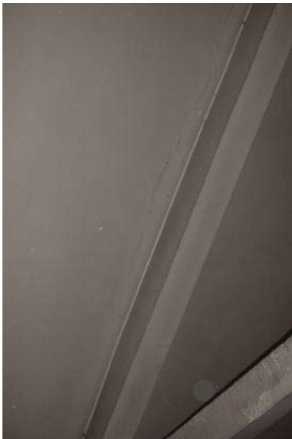
Foto 55. Zarysowanie płyty stropowej przy kratownicy łukowej w osiach 4-5.
