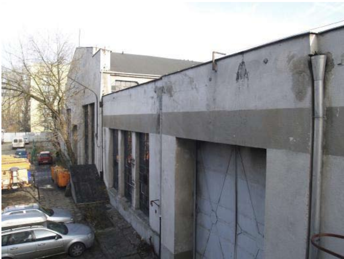
Foto 7. Widok na elewację fasadową (wejście od podwórza) – ubytki tynku i zwilgocenia.
