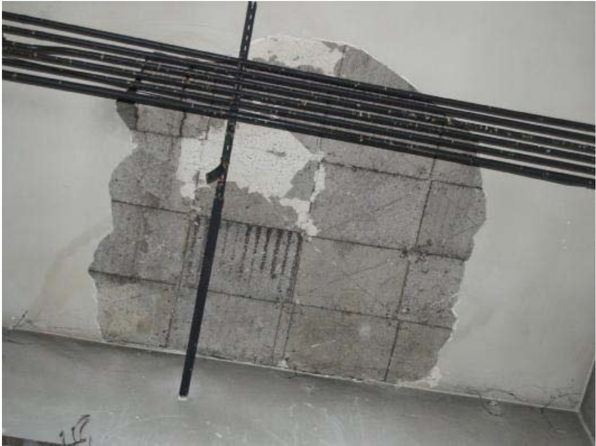
Foto 51. Widok ubytki tynku stropu (część północna budynku).
