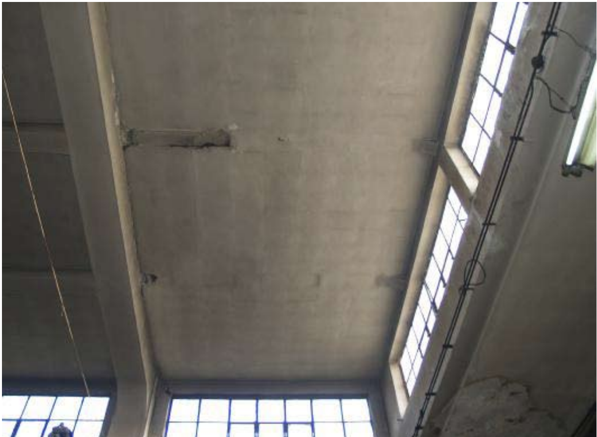
Foto 52. Uszkodzony sufit podwieszany w osiach B-C/2-3 w części południowej.
