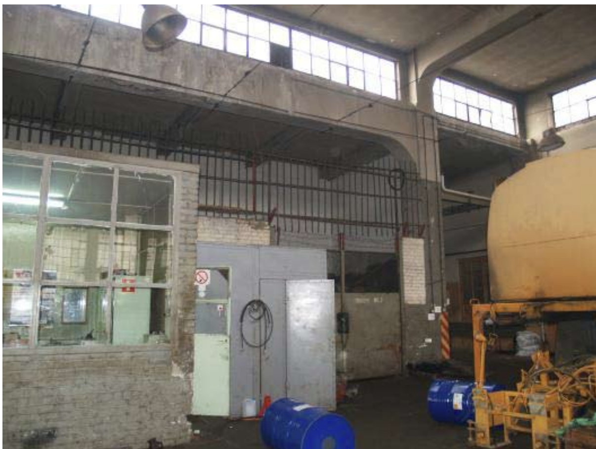
Foto 40. Skrzydło północne – widok na część budynku od strony podwórza (frontu) – zawilgocenie podciągu żelbetowego.
