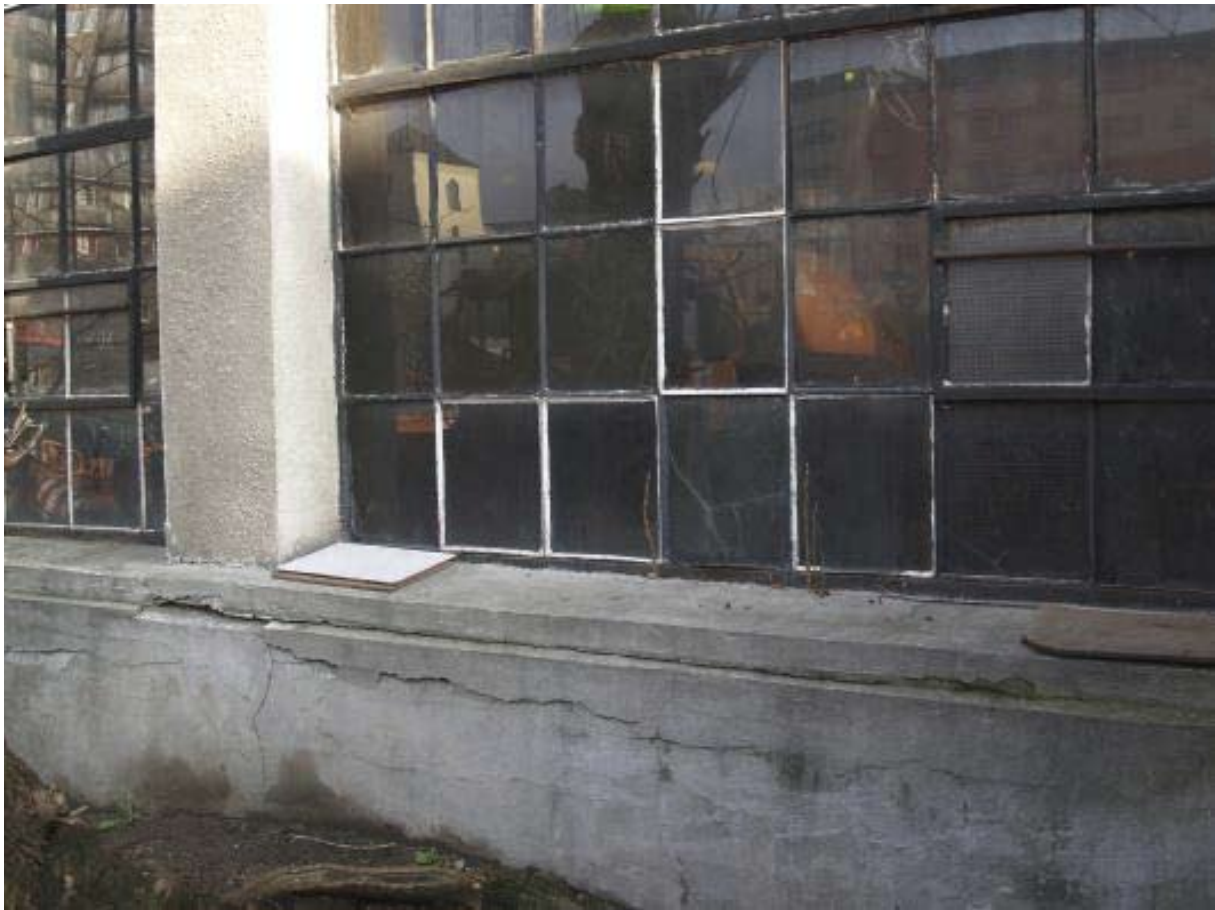
Foto 11. Spękanie poziome tynku przy oknach centralnej części elewacji frontowej.
