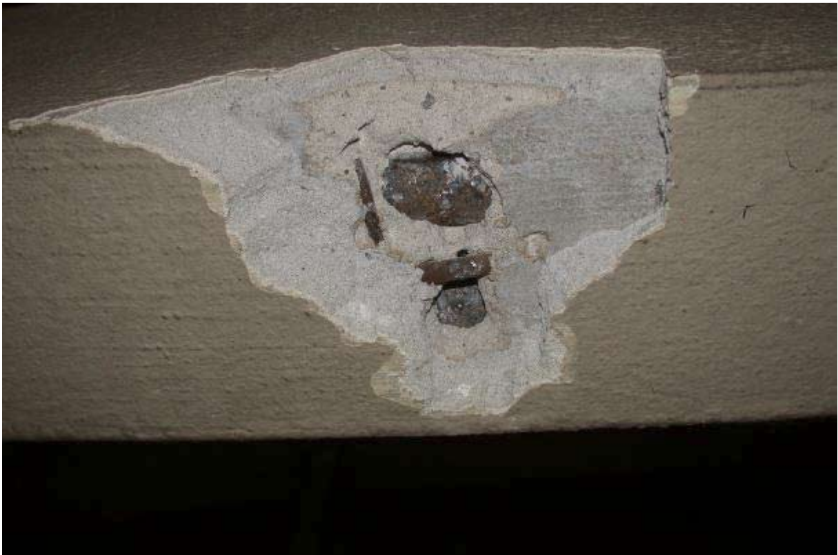
Foto 63. Odkrywka zbrojenia kratownicy łukowej w osiach 4-5.
