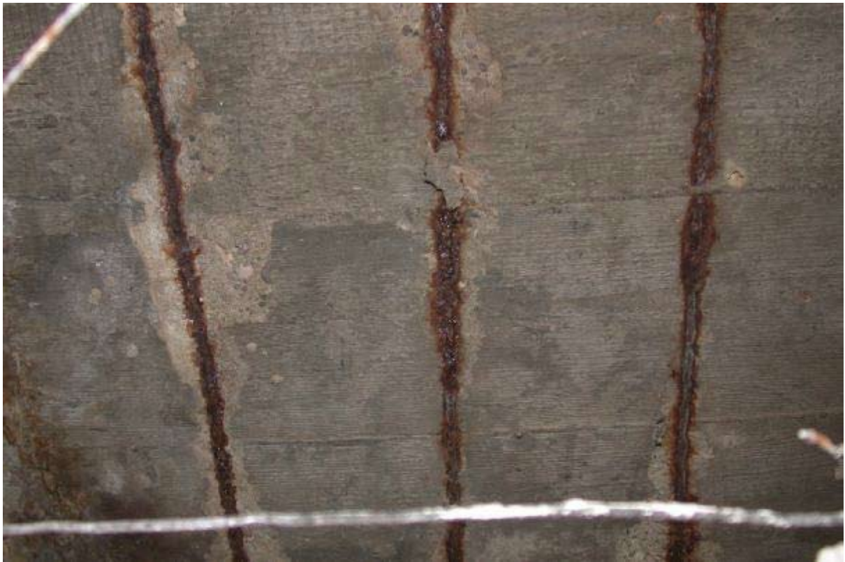
Foto 62. Korozja prętów zbrojeniowych płyty stropowej.
