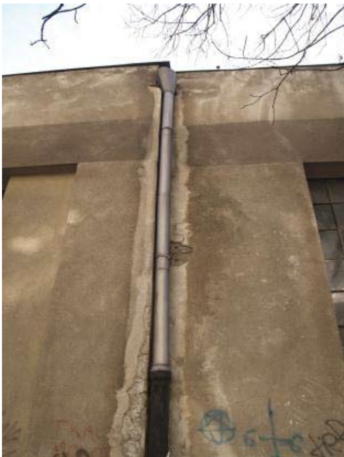
Foto 27. Widoczne ślady dawnego zawilgocenia ściany przy rurze spustowej wody z dachu
