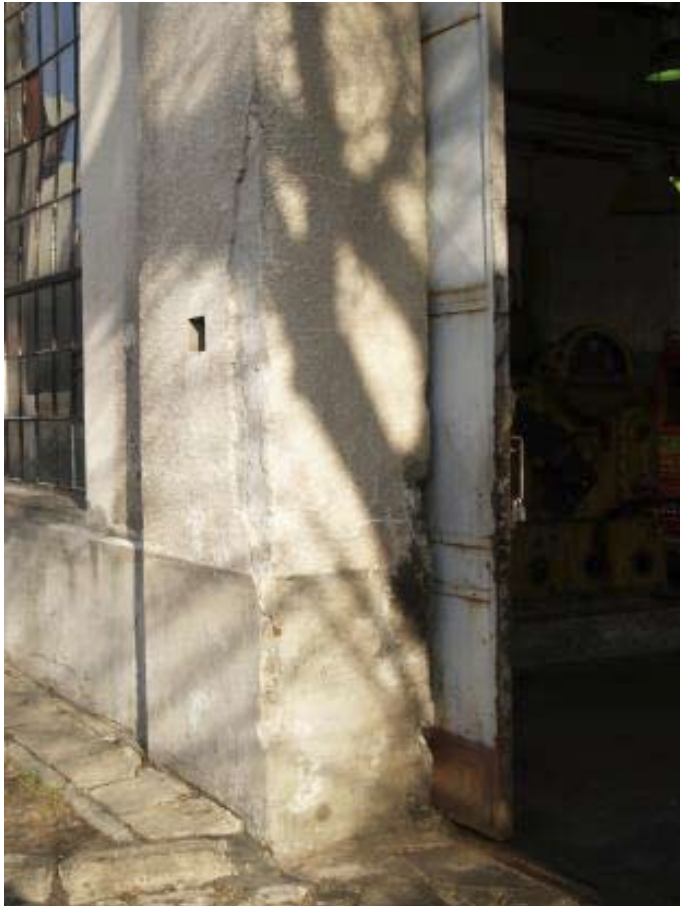
Foto 9. Ubytki tynku na narożnikach bram wjazdowych oraz zły stan techniczny bram.
