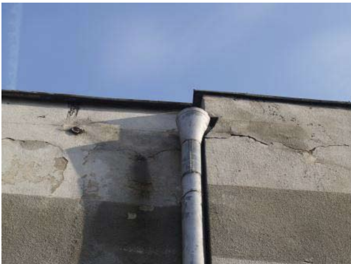
Foto 8. Widoczne zawilgocenia i pęknięcia poziome przy ściankach kolankowych.
