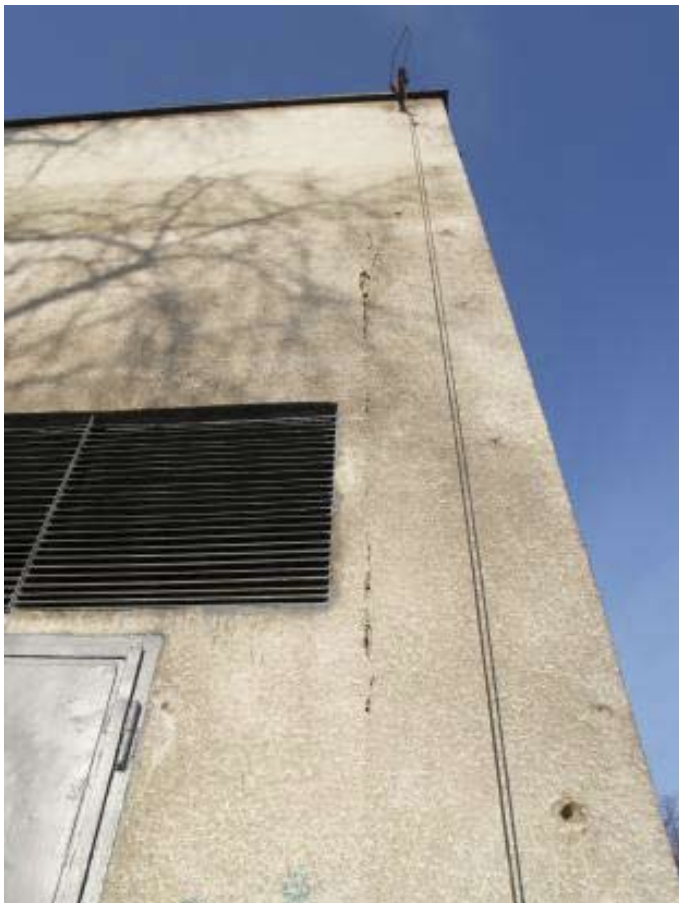
Foto 14. Widok na oddzielenie się konstrukcji słupów od ściany w narożniku elewacji.
