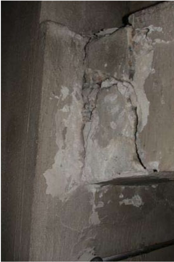
Foto 66. Ścięty wspornik żelbetowy w osiach C/2.
