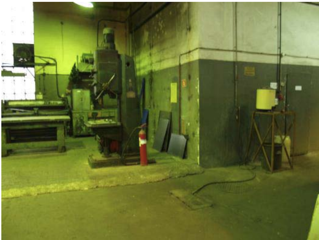
Foto 43. Skrzydło południowe –widok na narożnik ścian przy wejściu od łącznika oraz widok na różnice poziomów posadzki.
