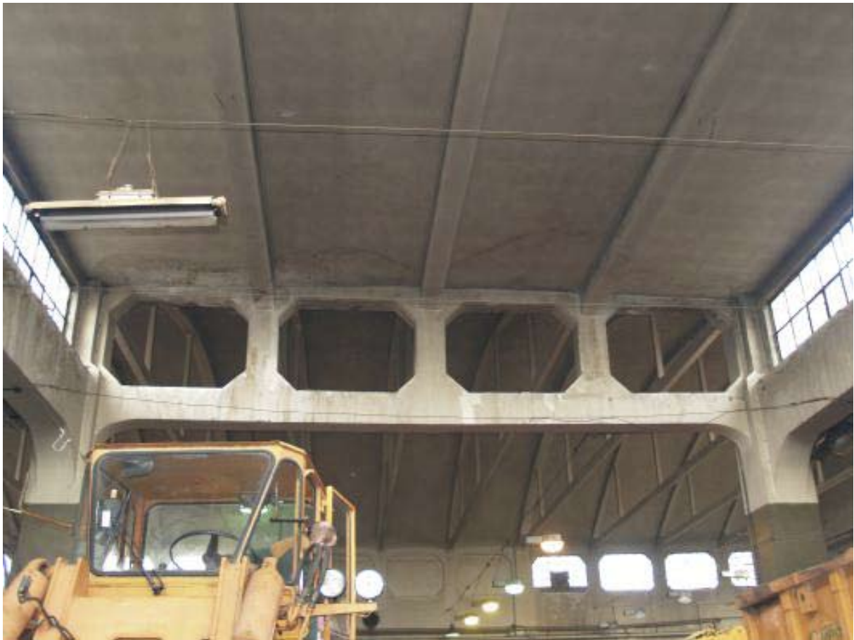
Foto 35. Widok na rozwiązanie konstrukcyjne hali widoczne zawilgocenie stropu.
