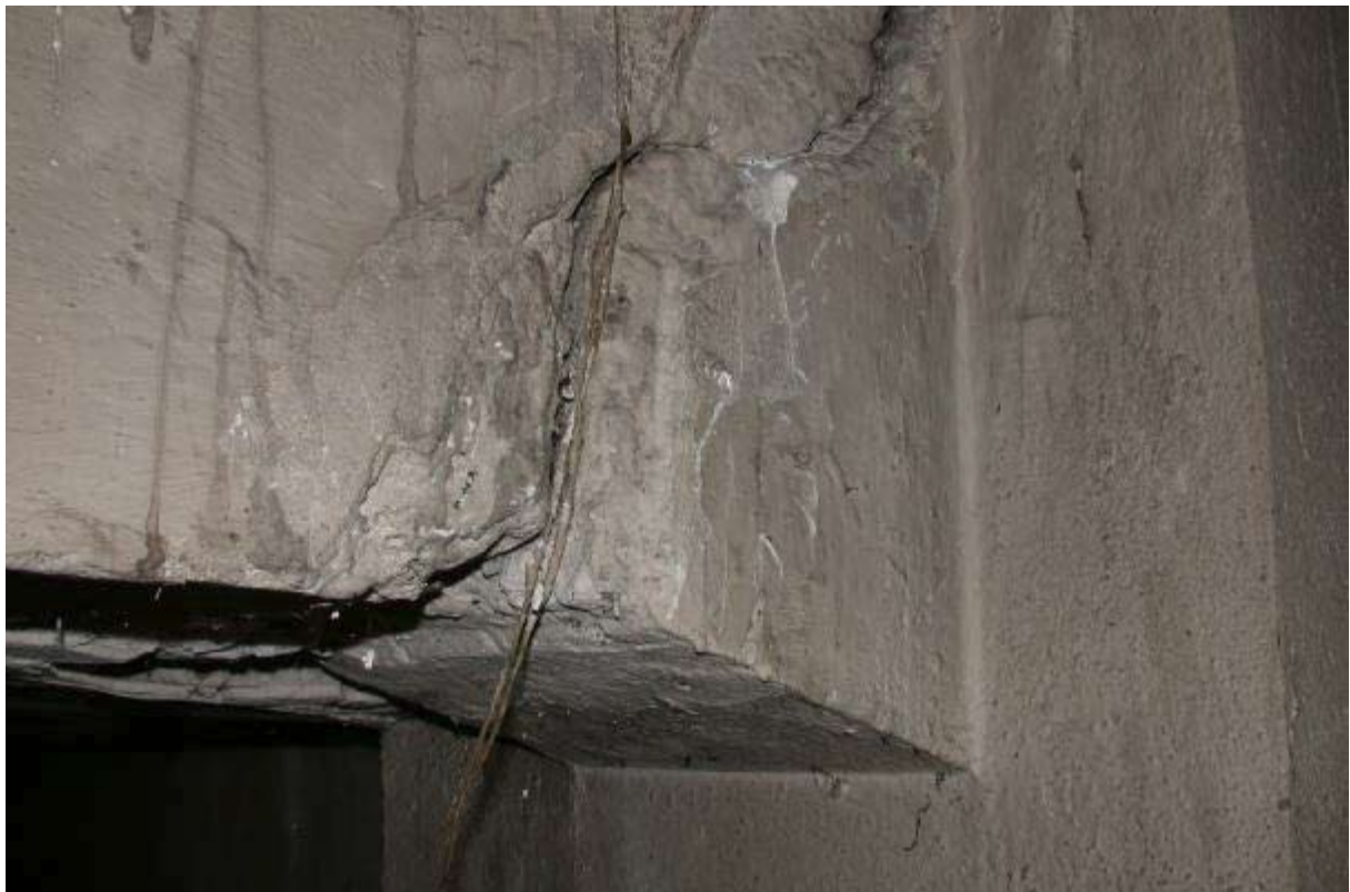
Foto 65. Wspornik żelbetowy belki w osiach B/2.
