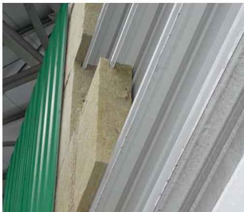
Widok na ścianę od strony zewnętrznej, płyty „uszyte na miarę” – krawędzie kaset wchodzą w kanały płyt
